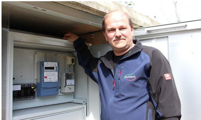
Projektbetreiber Michael Möblacher kontrolliert regelmäßig den Zählerstand bei der Trafostation Foto © Nicole Kari
